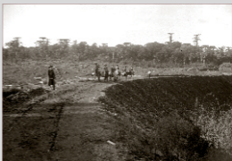
Vistoria das obras de construção da Estrada de Ferro, ramal ferroviário Caxias - Montenegro – Caxias do Sul [1909] – Autoria: Domingos Mancuso. Doação Francisco Fortuna – Acervo: Arquivo Histórico Municipal João Spadari Adami.
